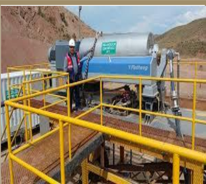
DECANTADOR CENTRIFUGO EMPRESA MINERA COROCORO
